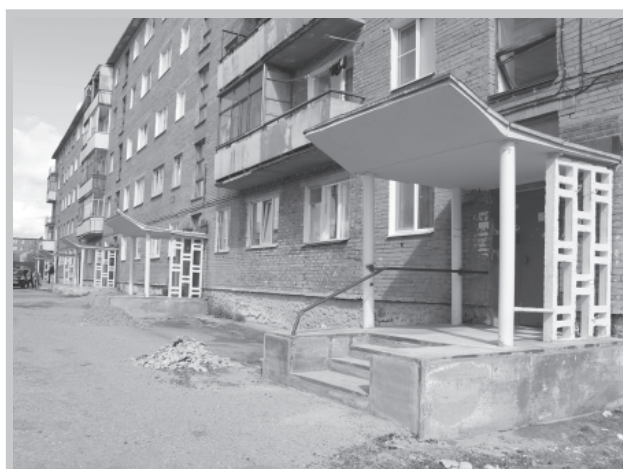
Ленинградской набережной, дом 30, корпус 2. Крыльца этого дома от времени начали обрушиваться. Теперь они восстановлены с обрамлением металлическим уголком.
